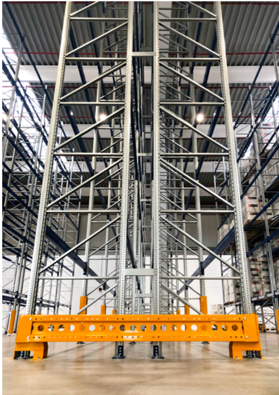
Palettenregal Pallet Racking
